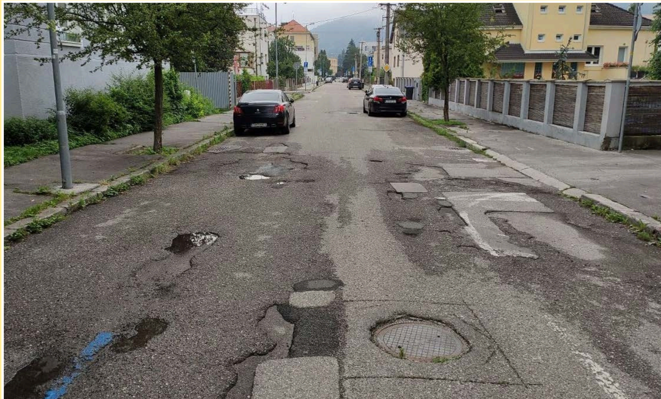
Rozbitá cesta - větší úsek
