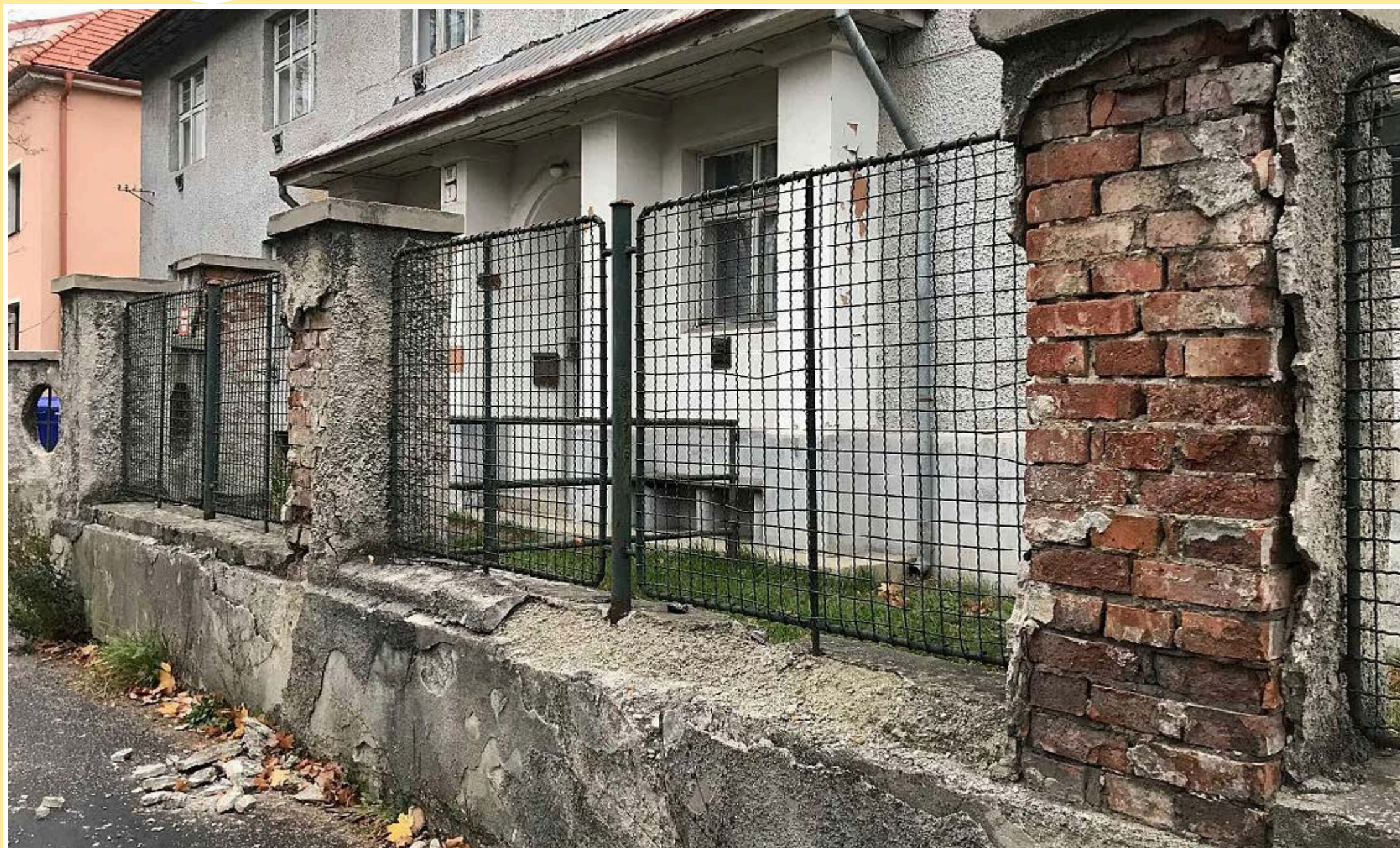
Budova v zlom stave
